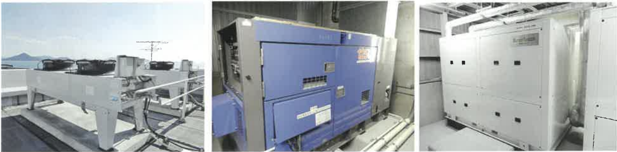
瀬戸内海をのぞむ屋上に設置された最新型の室外機をはじめ、充実の設備システムが整えられている。
